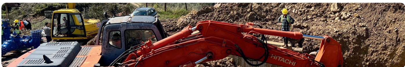
Punime në ndërtimin e sistemit të ri të kanalizimeve për mbrojtjen e puseve të ujit të pijshëm.
