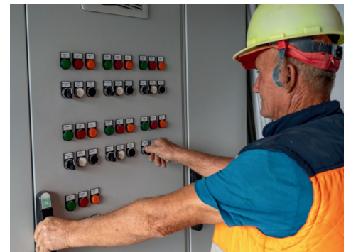
Paneli i kontrollit të rezervuarit të rehabilituar të Krastës së Madhe.
