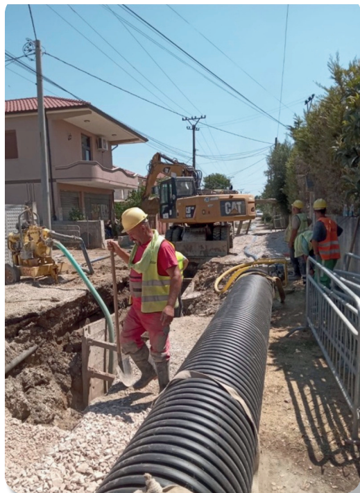
Tuba kolektorë kryesorë të mëdhenj për grumbullimin e ujërave të ndotura.
